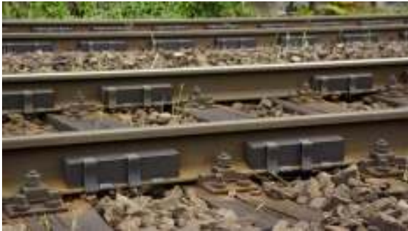
Abbildung 55: Schienenstegdämpfer im Verlauf der Elbtalstrecke.
