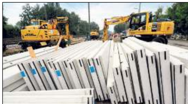
Etwa 1,2 Tonnen schwer sind die Betonelemente, die am Sockel der Lärmschutzwand montiert werden.
