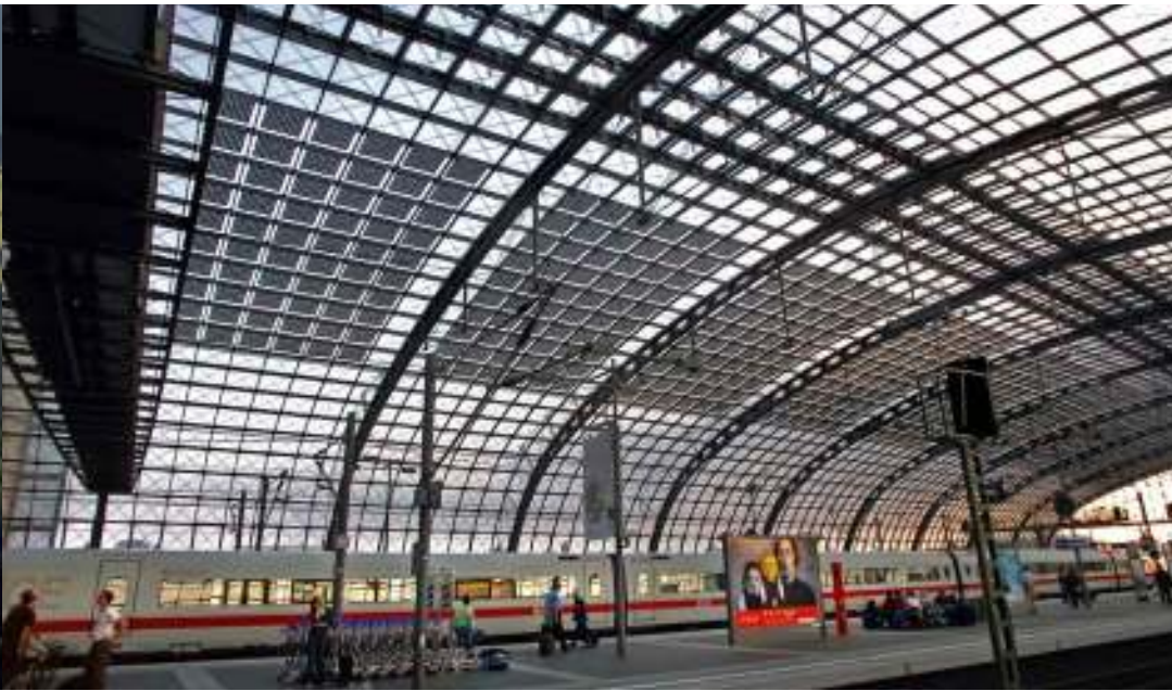
Photovoltaik auf dem Dach des Berliner Hauptbahnhofs
